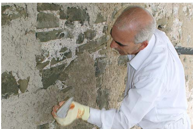
Franco Mazzai bei der sanften Sanierung eines Abschnitts zwischen Wacht- und Zytturm (Foto Sebastian Meyer)
