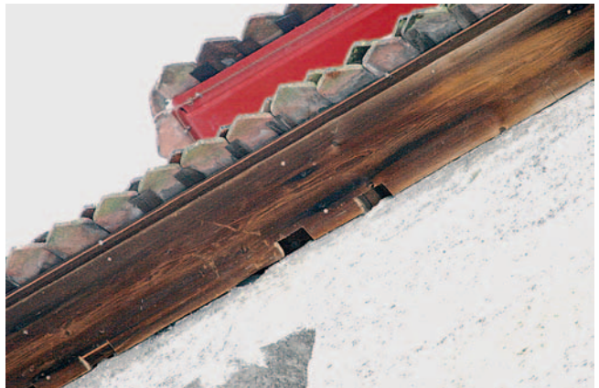
Neue Alpensegler-Löcher in der Dachuntersicht des Wachturms. (Foto Sebastian Meyer)
