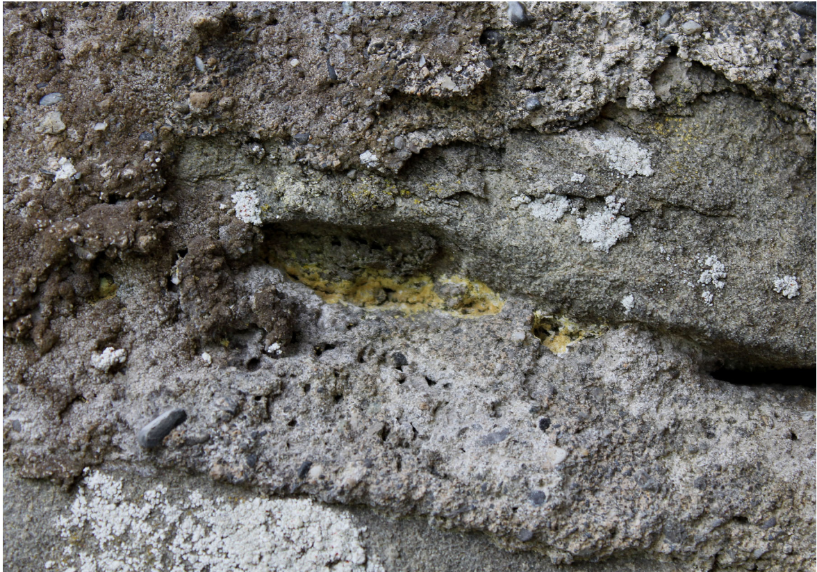
Abbildung 21: Die gelb-orange gefärbte Krustenflechte Caloplaca chrysodeta wächst an der Museggmauer stets in mehr oder weniger regengeschützten Nischen und ist für einen Fortbestand entsprechend auf deren Erhalt angewiesen
