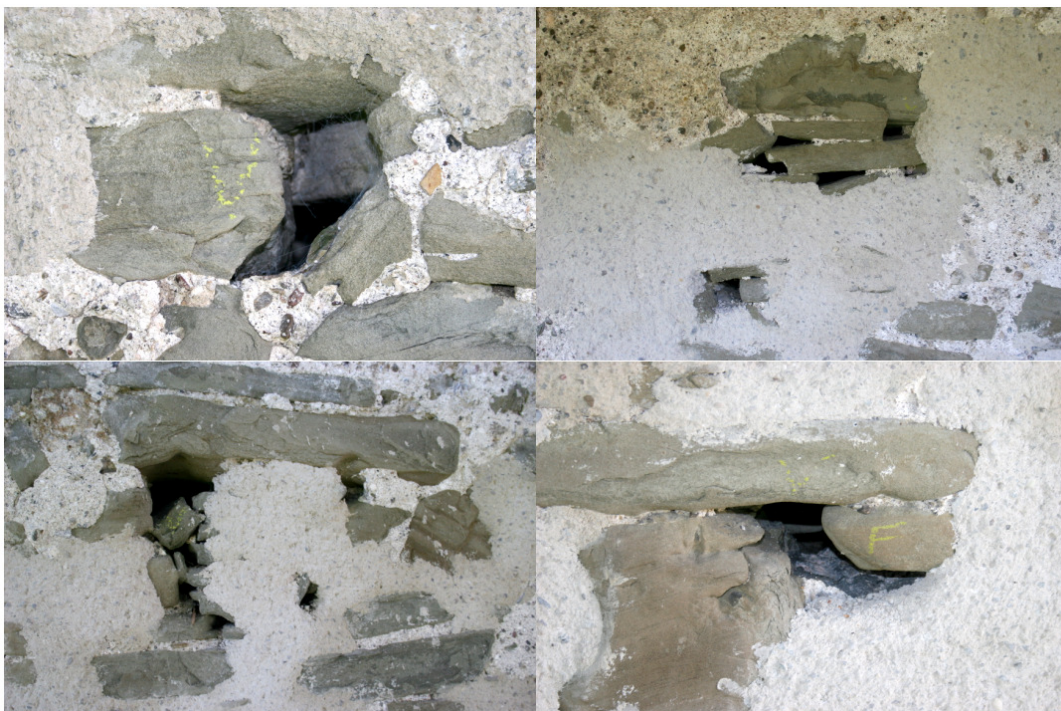
Abbildung 11: Dieselben vier Mauersegler-Brutplätze nach der sanften Sanierung (Fotos: Sebastian Meyer)
