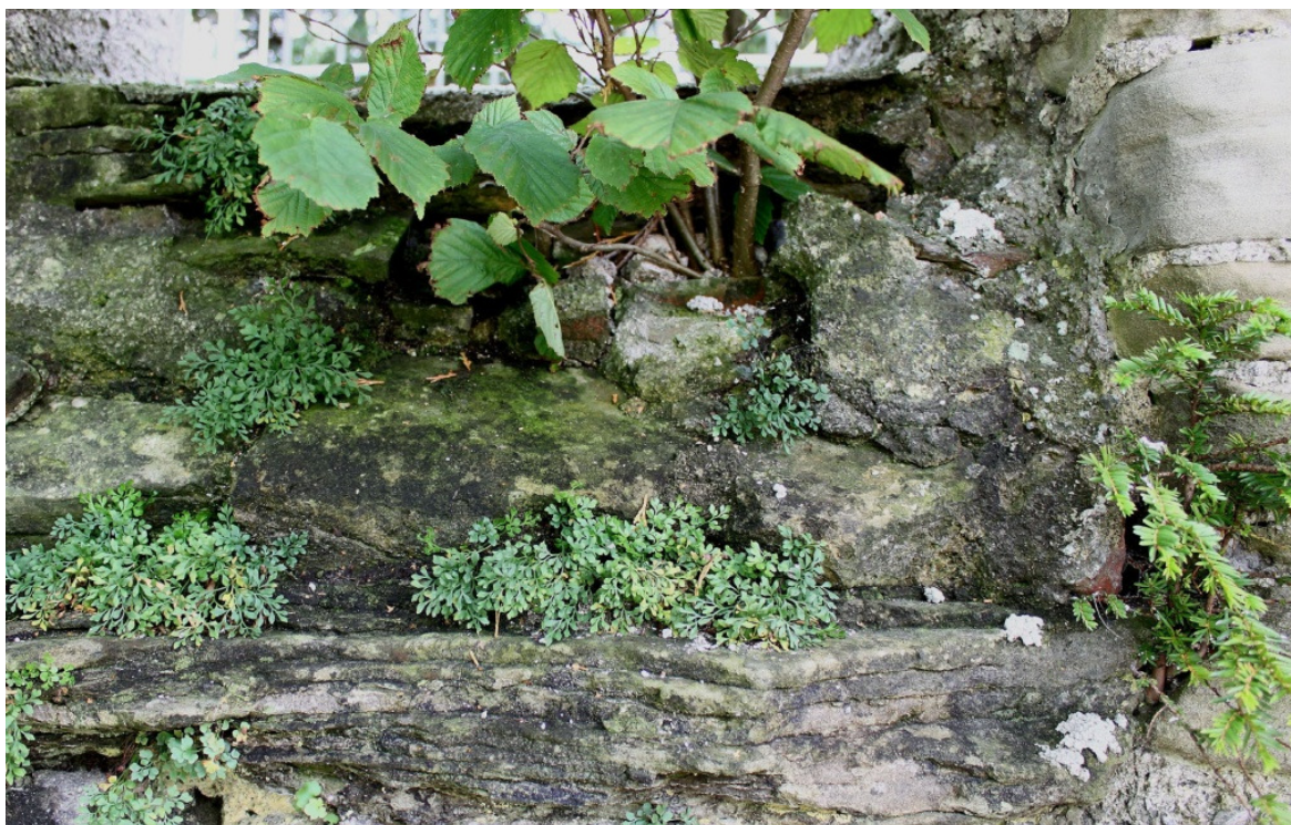
Abbildung 17: Vor allem im obersten Bereich, unter den schadhafte Scharten und Zinnen, konnten sich neben der Mauerraute auch Haselstrauch und Eibe gut entwickeln.
