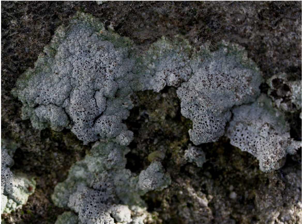
Abbildung 19: Die Krustenflechte Diposchistes gypsaceus kommt auf dem Putz der Südseite mit mehreren grösseren Lagern vor.
