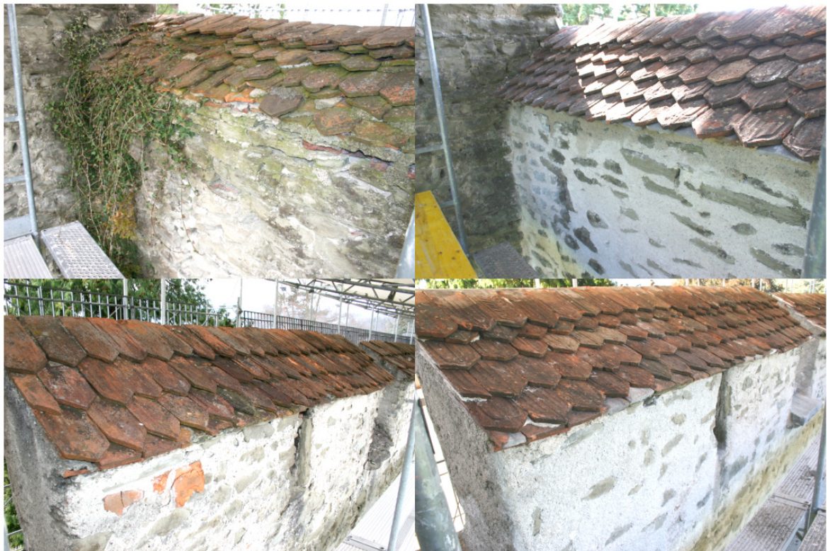
Abbildung 7: Dieselben zwei Zinnen auf der Nordseite vor (links) und nach (rechts) der Sanierung. (Fotos: Sebastian Meyer)
