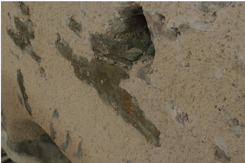
Abbildung 26: Nach Abschluss der vorbildlichen Putzarbeiten sind weiterhin offene Sandsteinblöcke mit erkennbaren Flechtenlagern am Gemäuer des Allenwindenturms vorhanden.
