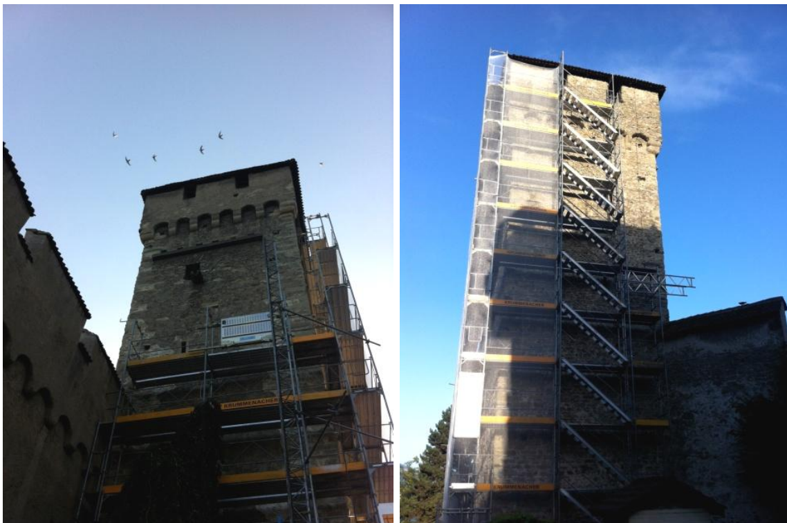
Abbildung 13: Allenwindenturm mit Gerüstlücken auf der Ostfassade (links) und Westfassade (rechts). (Fotos: Sebastian Meyer)
