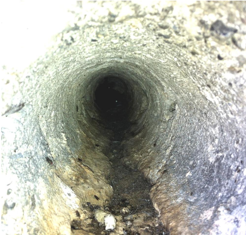
Abbildung 15: Blick in ein röhrenförmiges Fassadenloch. Ganz vorne liegt ein Kotbällchen eines Alpenseglers. Ganz zuhinterst ist die den Blitz des Fotoapparats reflektierende Netzhaut eines Alpensegler-Nestlings zu erkennen. (Foto: Sebastian Meyer)
