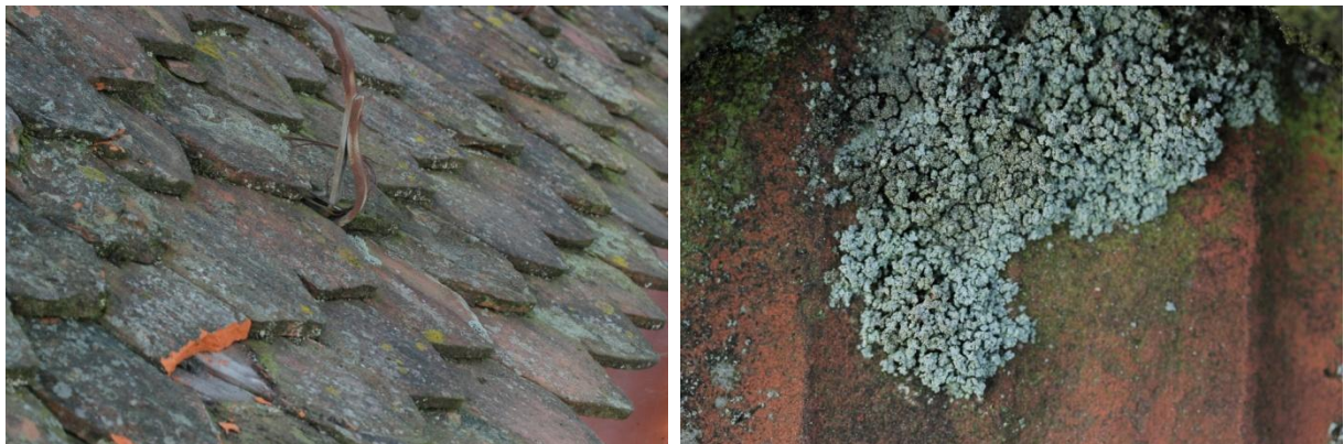
Abbildung 24: Die strauchförmig wachsende Stereocaulon nanodes wächst auf dem Dach bevorzugt im Bereich von eisenbeeinflussten Stellen, links im Zentrum des Bildes.
