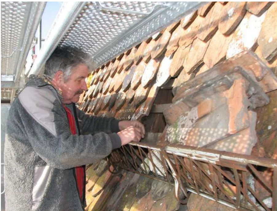
Abbildung 1: Walti Würsch deckt sorgfältig Ziegel ab, damit nach Fledermausspuren gesucht werden kann.
