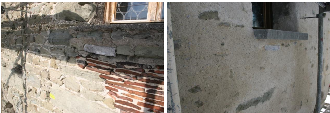
Abbildung 11: Ausschnitte aus der Süd-Fassade vor (links) und nach (rechts) der sanften Sanierung. (Fotos: Sebastian Meyer)
