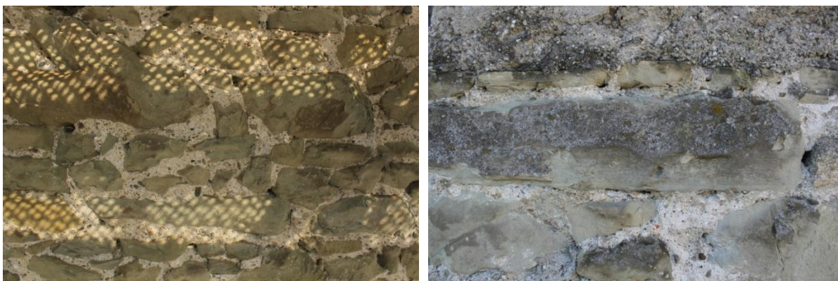
Abbildung 19: Die Mauerflächen des Dächliturms sind vielerorts tief erodiert. Nur vereinzelt finden sich Sandsteinblöcke mit augenfälligen Flechtenlagern (rechts).
