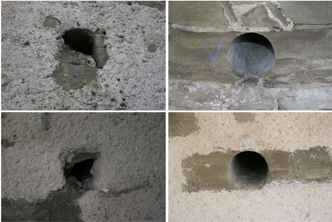
Abbildung 8: Mauersegler-Brutplätze zwischen Pulver- und Allenwindenturm vor (oben) und nach (unten) der sanften Sanierung. (Fotos: Sebastian Meyer)
