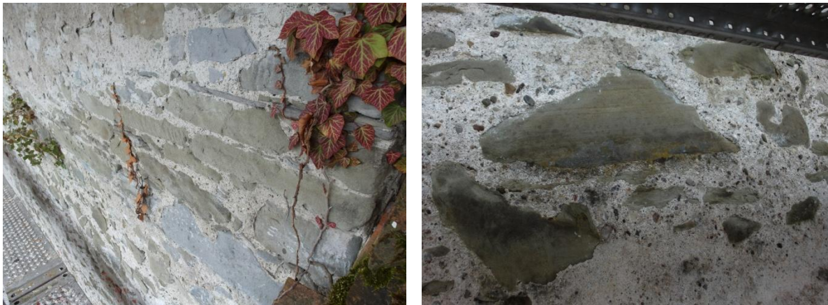
Abbildung 14: Auf der Nordseite der Mauer ist verschiedentlich Efeu vorhanden, der mit entsprechender Schädigung auch ins Gemäuer vorgedrungen ist. Die vermehrt offen liegenden Sandsteinblöcke werden von den typischen Flechtenarten geziert.
