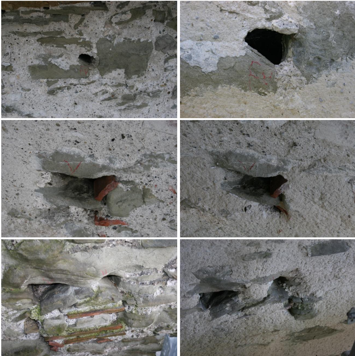
Abbildung 7: Mauersegler-Brutplätze zwischen Schirmer- und Pulverturm vor (links) und nach (rechts) der sanften Sanierung. (Fotos: Sebastian Meyer)
