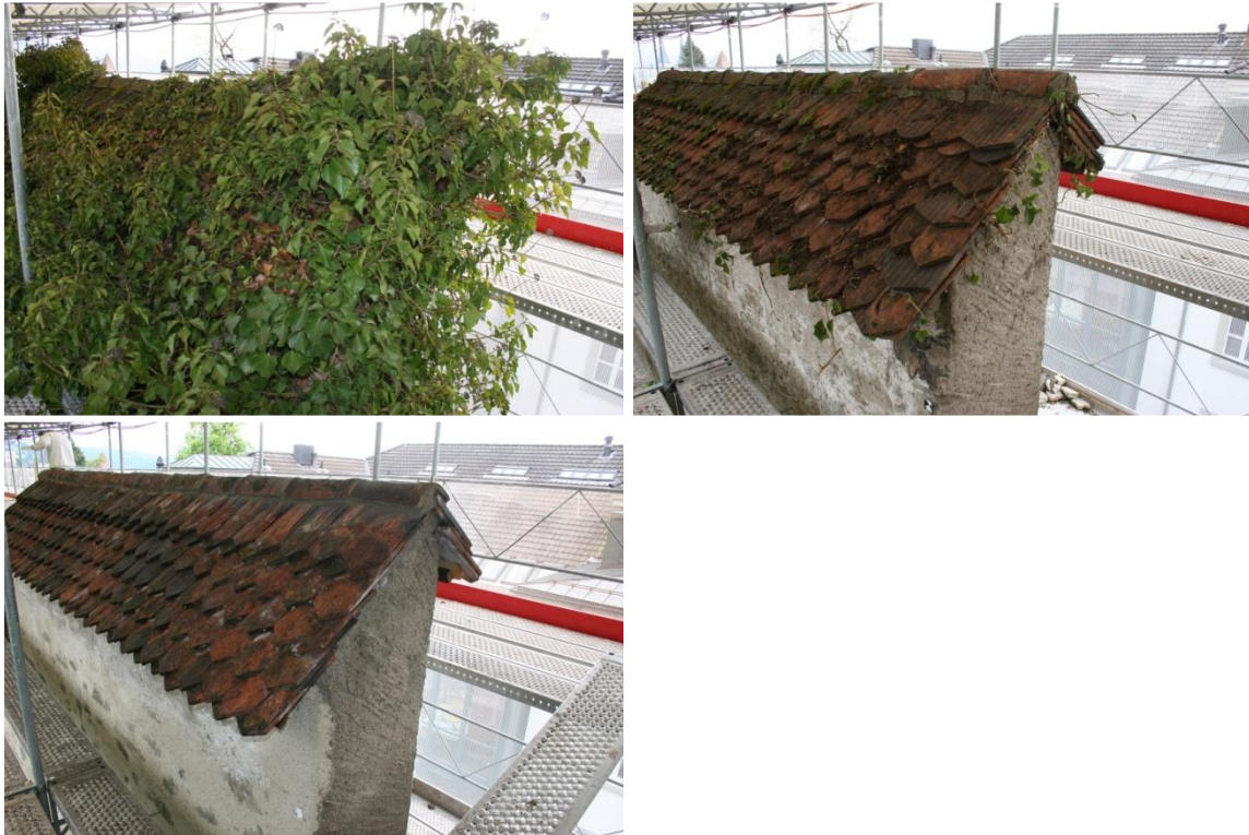
Abbildung 5: Zinne zwischen Pulver- und Allenwindenturm vor Entfernen des Efeus (links oben), vor der sanften Sanierung (rechts oben) und nach der sanften Sanierung (links unten). (Fotos: Sebastian Meyer)
