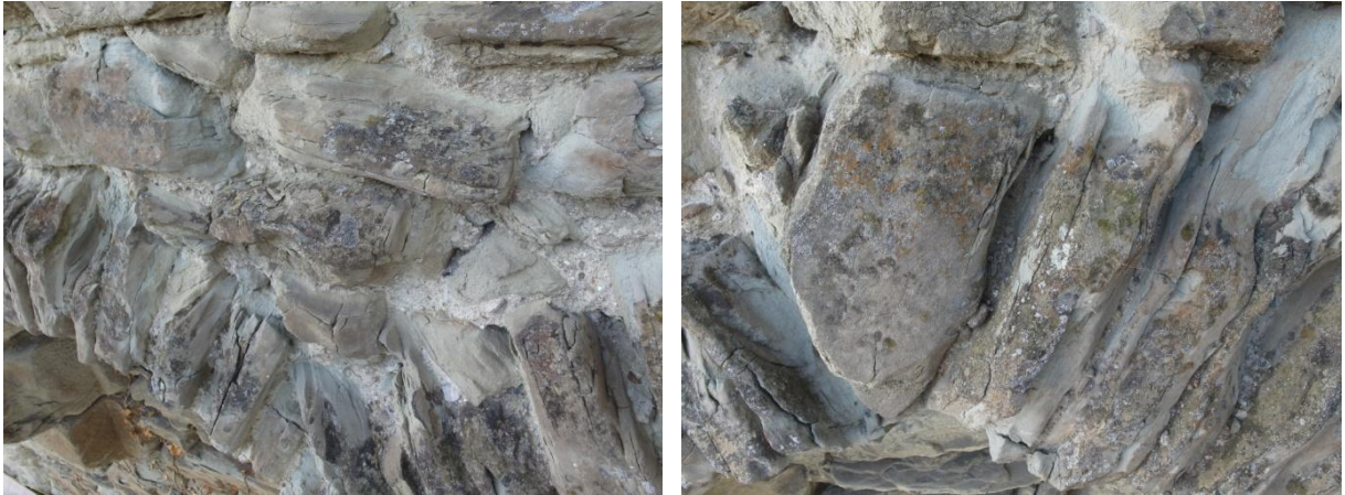
Abbildung 19: Die Mauerflächen des Pulverturms gleichen vielerorts einem ausgewachsenen Sandsteinfelsen an dem nur vereinzelt Krustenflechten an noch kompakten Sandsteinblöcken überdauern können.
