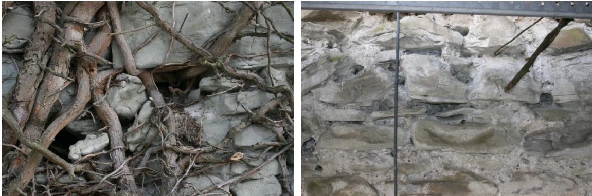
Abbildung 8: Fassadeausschnitt mit Efeuschäden. (Fotos: Sebastian Meyer)
