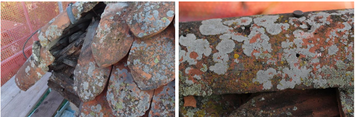
Abbildung 20: Schadhafte Stellen im Bereich der Firstziegel führten zur Verwitterung des Unterbaus. Nicht von Mörtelflicken basisch beeinflusste Firstziegel tragen ein Mosaik aus typischen Krustenflechten.
