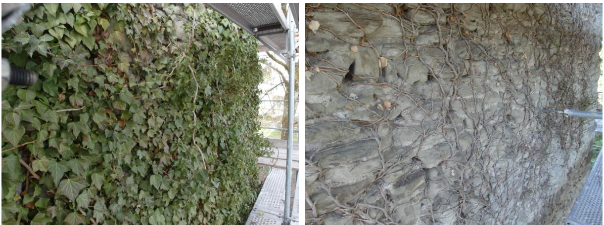
Abbildung 18: Der Efeubewuchs verhindert durch seine Dichte auf grossen Flächen das Auftreten von gesteinsbewohnenden Flechten. Unter dem ausgedehnten Netzwerk der Ranken sind die Mauern zudem tief erodiert.
