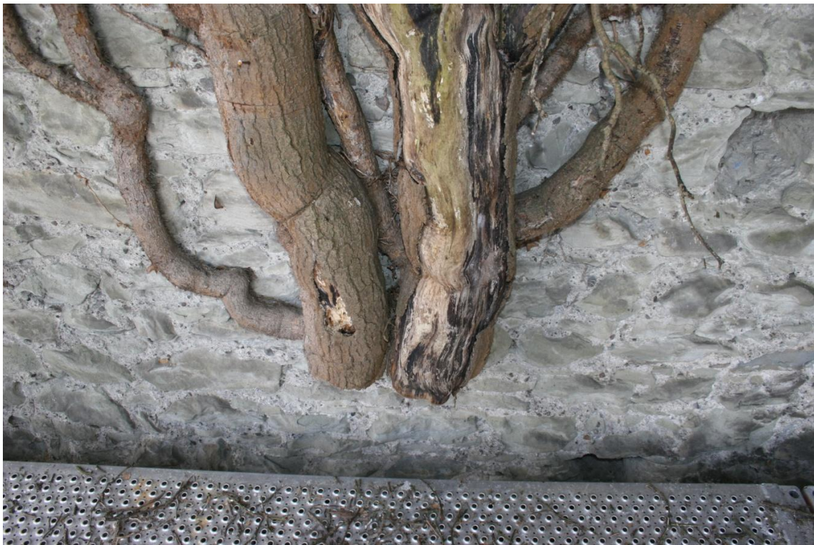
Abbildung 9: Trotz abgetrenntem Wurzelstock hat der Efeu überlebt, indem er Wasser mit seinen Haftwurzeln aus der Fassade und Luft herauszog. (Fotos: Sebastian Meyer)
