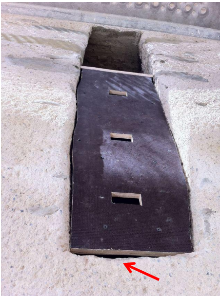
Abbildung 4: In einer Fenster­nische auf der Südseite wurde ein Kombinationskasten Mauer­segler/Fledermäuse integriert. Pfeil: Einsch­lupf für Fledermäuse.
