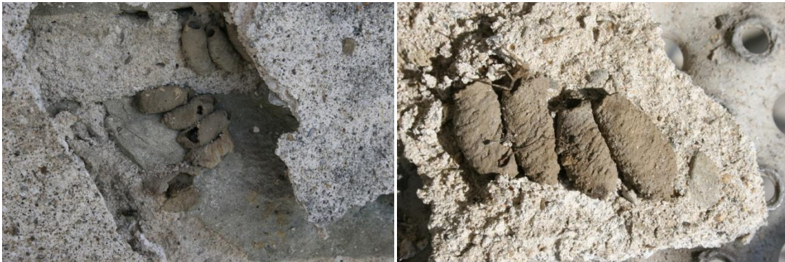
Abbildung 14: Nester von Orientalischen Mörtelwespen hinter abstehendem Verputz auf der Südseite. (Fotos: Sebastian Meyer)
