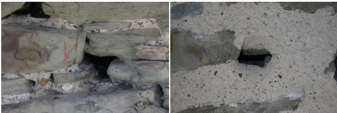
Abbildung 9: Mauersegler-Loch vor (links) und nach (rechts) der sanften Sanierung. (Fotos: Sebastian Meyer)
