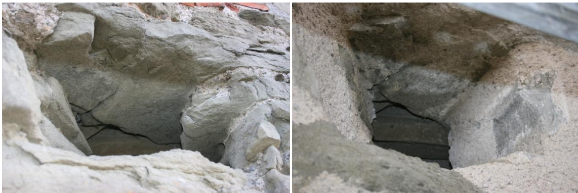
Abbildung 8: Dohlen-Loch vor (links) und nach (rechts) der sanften Sanierung. (Fotos: Sebastian Meyer)
