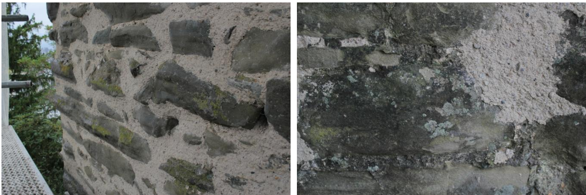
Abbildung 19: Nach den Restaurierungsarbeiten finden sich an den Mauern des Männlitorms immer noch zahlreiche Sandsteinblöcke mit üppigem Flechtenbewuchs. Auch die an unauffälligen Krustenflechten reichen basalen Mauerpartien wurden wo notwendig so verputzt, dass eine Mehrheit der Flechtenlager überdauern konnte (rechts).
