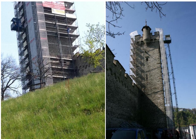
Abbildung 10: Gerüstlücke auf der Westseite (links) und fehlendes Gerüst auf der Ostseite (rechts). (Fotos: Sebastian Meyer)
