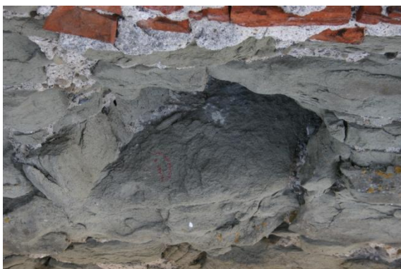
Abbildung 7: In dieser Nische brüteten in den 1980er-Jahren Turmfalken, im Jahr 2000 die erste Gänsesägerin an der Museggmauer; die Nische wird aber auch von Dohlen benutzt. Nische vor der sanften Sanierung. (Fotos: Sebastian Meyer)
