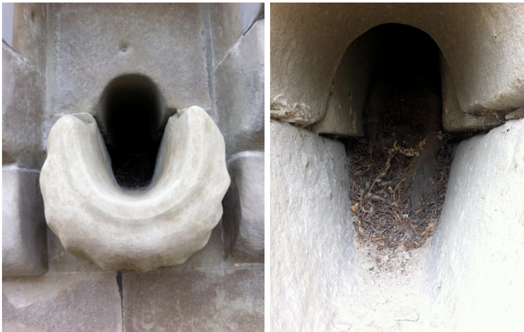
Abbildung 6: Taubennest in einem steinernen Wasserspeier vor der Sanierung. (Fotos: Sebastian Meyer)
