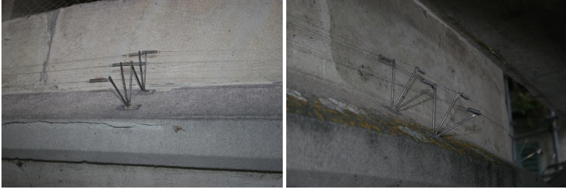
Abbildung 14: Sims mit Taubenabwehrdrähten vor der Sanierung. (Fotos: Sebastian Meyer)
