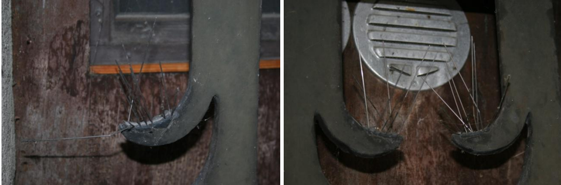
Abbildung 12: Türe über der Brüggligasse mit Taubenabwehrspikes vor der Sanierung. (Fotos: Sebastian Meyer)
