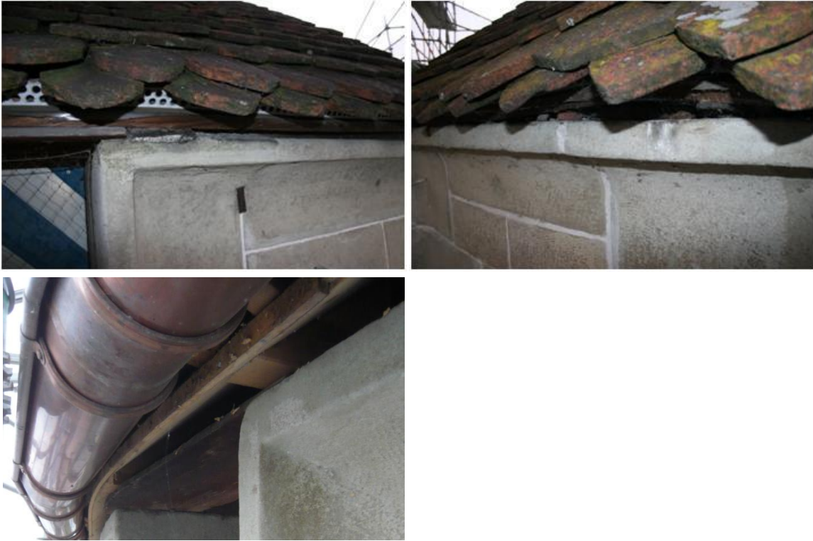
Abbildung 4: Ausschnitte aus dem Übergang von Dach zu Fassade vor (oben) und nach (unten) der sanften Sanierung. (Fotos: 2x Sebastian Meyer, 1x Nils Wimmer)
