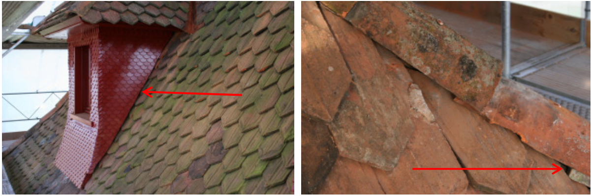
Abbildung 6: Im Dachbereich blieben zahlreiche Spalten als Einschlüpfte für Fledermäuse bestehen.
