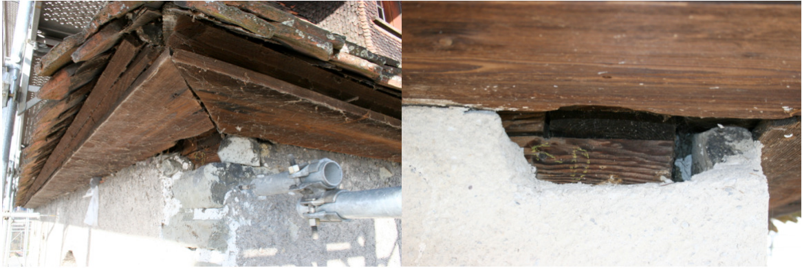
Abbildung 15: Dohlen-Nester vor (links) und nach (rechts) der sanften Sanierung. (Fotos: Sebastian Meyer)
