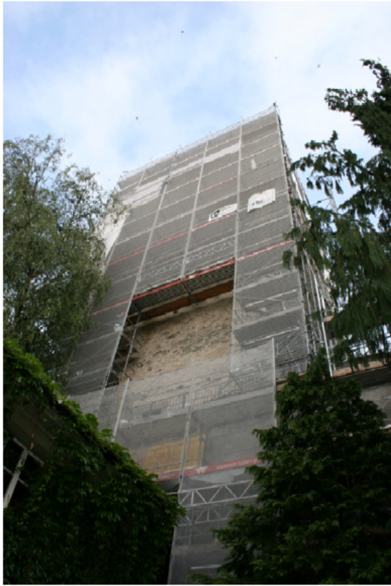
Abbildung 16: Gerüstlücke auf der Südseite (in der Luft sind fliegende Mauersegler knapp erkennbar). (Foto: Sebastian Meyer)
