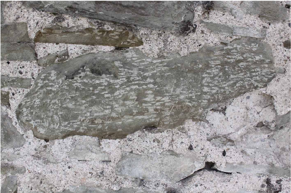
Abbildung 26: Die offen liegenden Sandsteinblöcke der Wachturm-mauern wurden vielerorts intensiv mit dem Meissel bearbeitet, für die vorhandenen Flechten mit verheerenden Folgen.
